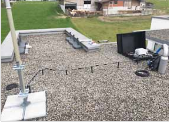
Speiseleitung mittels Hühnerleiter
