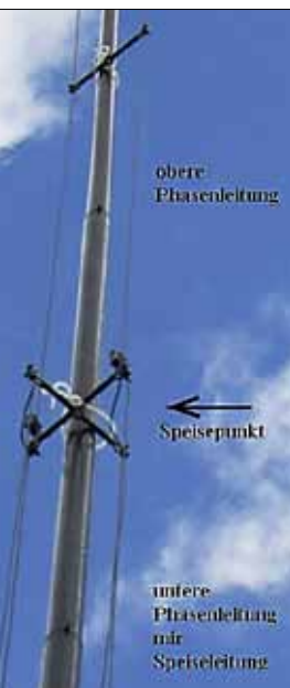
Abb. 44: Speisepunkt, Phasen- und Speiseleitung am DJ4VM-Loop
