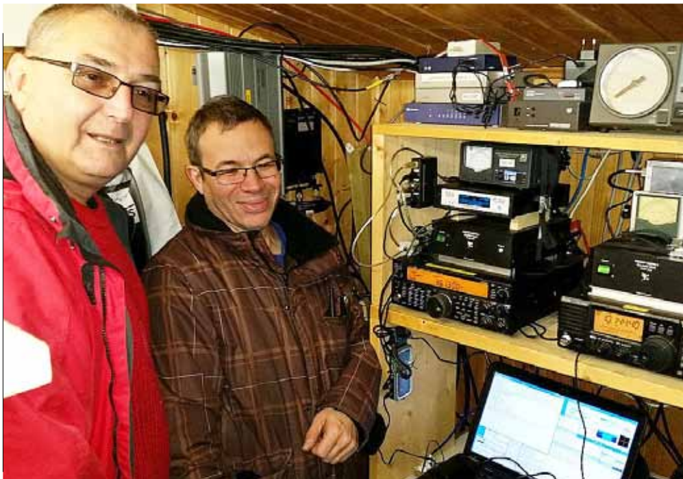
Peter Geissbühler HB9RNS (l.) und Rolf Tschumi HB9SDB, dahinter der Hytera RD625 - DMR-Repeater (an der Wand)
