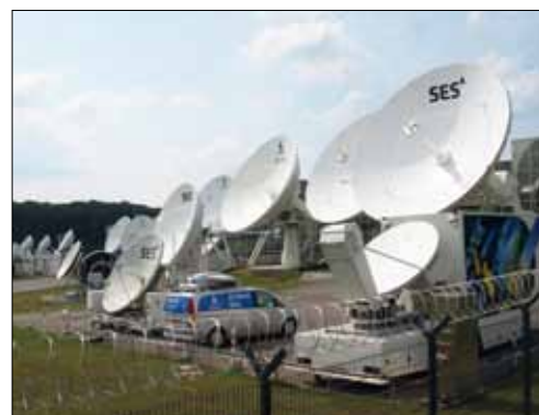
Le champ d'antennes paraboliques de la Maison SES
