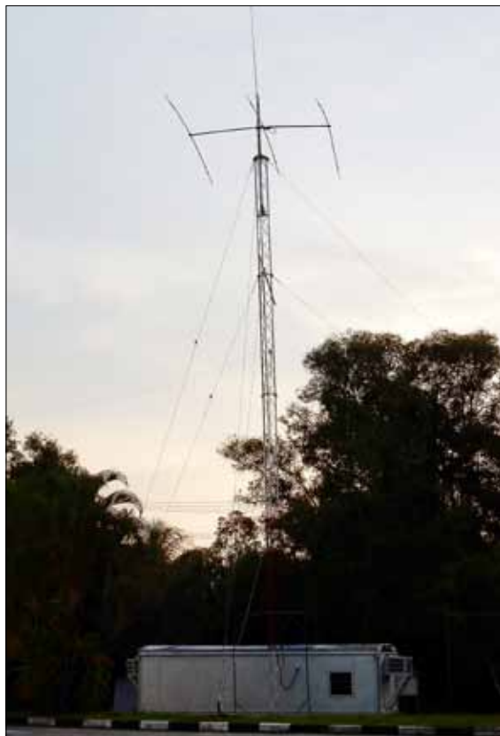
Container-Shack avec Beam 3el. sur 12m
