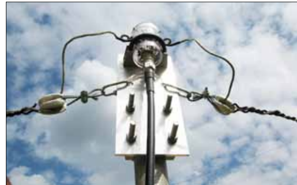
Einspeisepunkt des NVIS-Dipols
