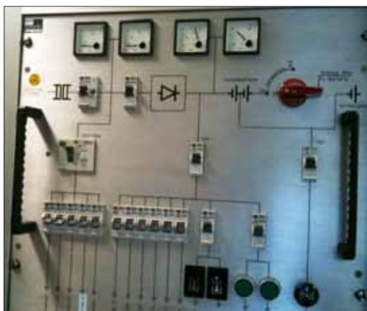
Le tableau de distribution (voir en bas)
