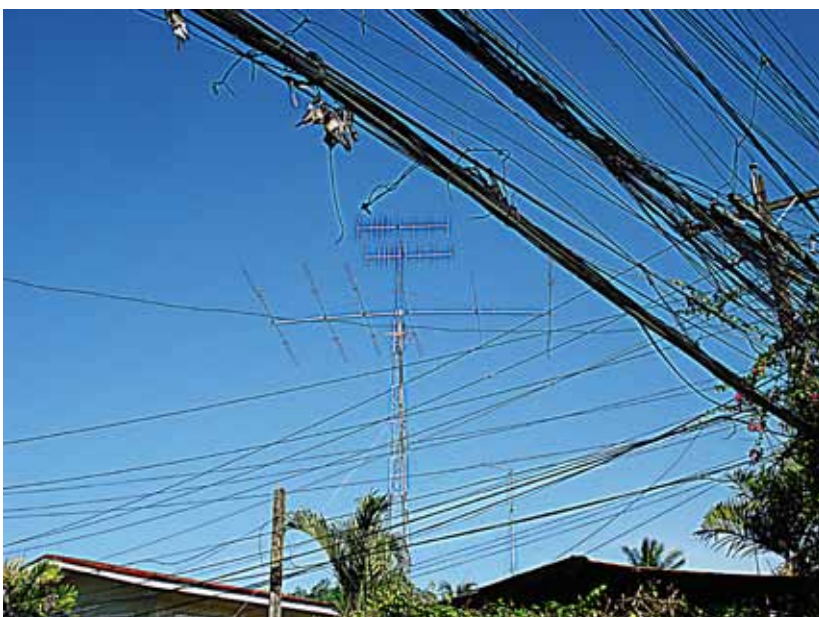
6 el. 3-Bandbeam von DU7UK in einem Wald von Freileitungen
