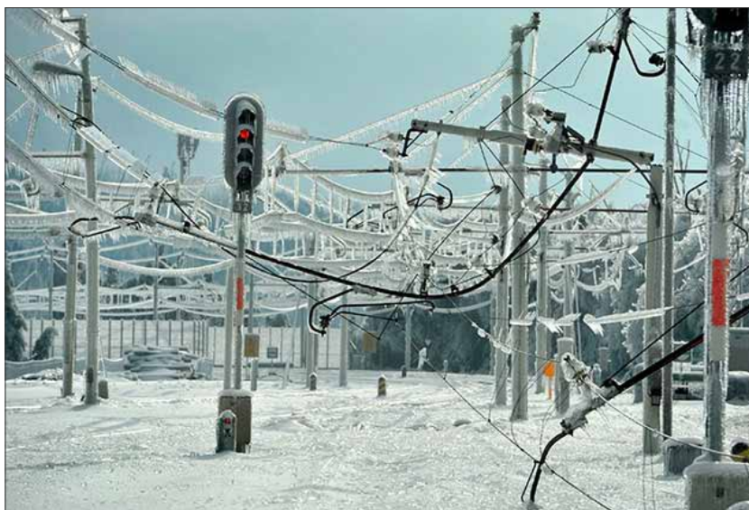
La Slovénie début Février: un quart des ménages était sans électricité
