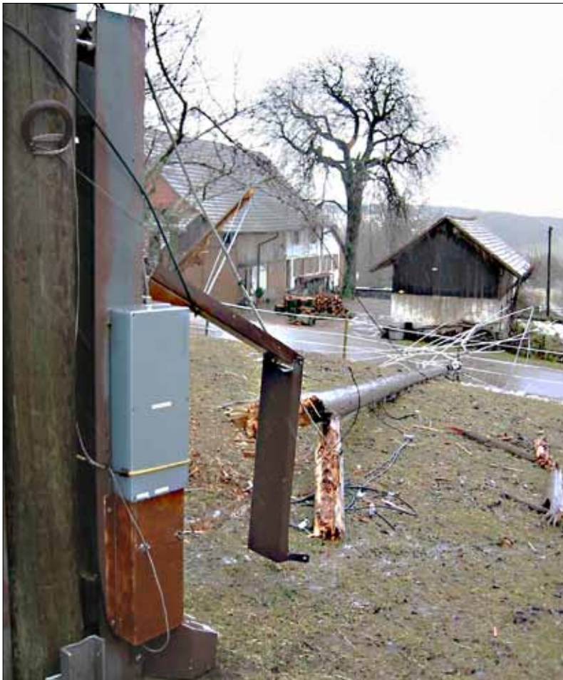
VORHER - Mastbruch beim Sturm vom 10. Feb. 2009. Immerhin hat der imprägnierte (nicht richtig kippbare) Mast aus Fichtenholz seit 1971 überlebt ...
