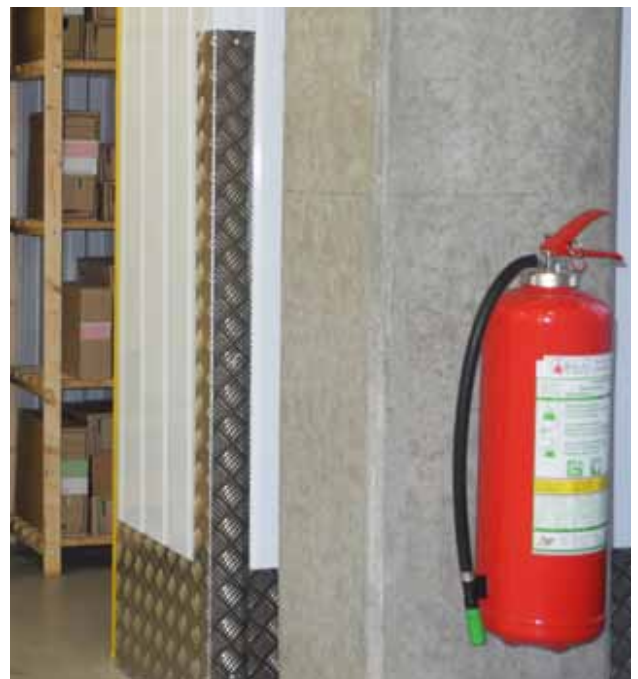
Bild 6: sogar der Feuerlöscher ist stets zur Hand
