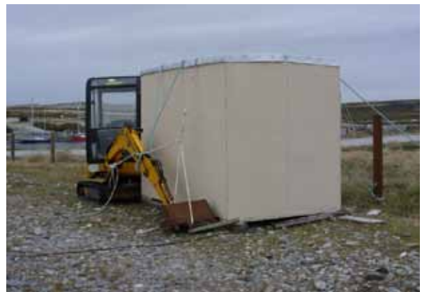
Die "Hütte" - das 2. QTH - mit Bagerverstärkung
