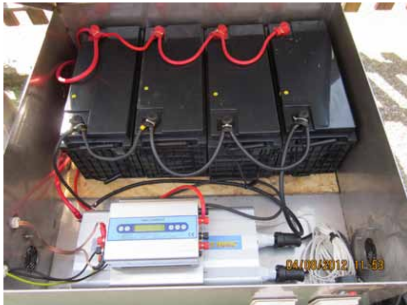
foto 4 / Bild 4: Alimentation de secours avec onduleur et PC de pilotage
