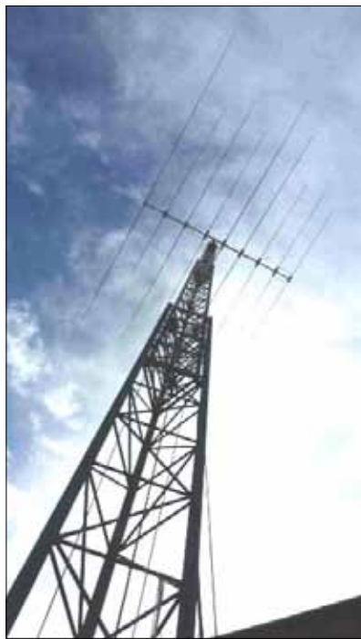
HB9BSL: neuer Opti-Beam läuft ufb
