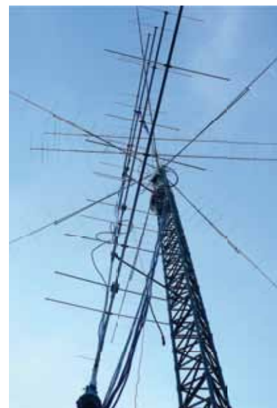
L'installation d'un vainqueur: les antennes de la station DR9A qui a remporté les contests IARU région 1, sur 144 MHz comme sur 432 MHz. (photo DR9A)
