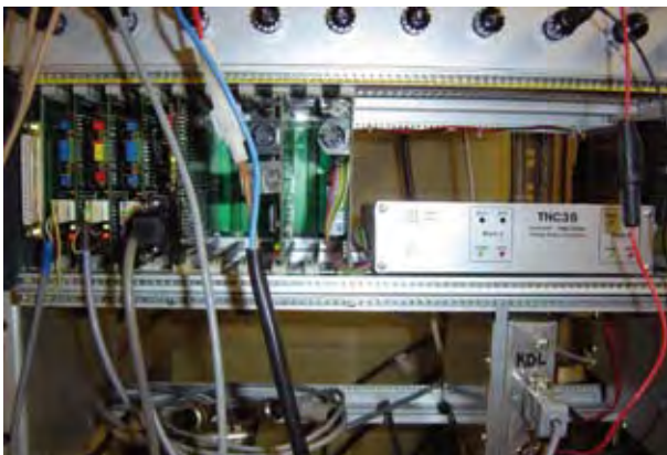
Verbindende Elektronik: Teil des Digipeater-Racks von HB9EAS.
