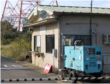
SECURITY OFFICE 前の発電用コンプレッサー
